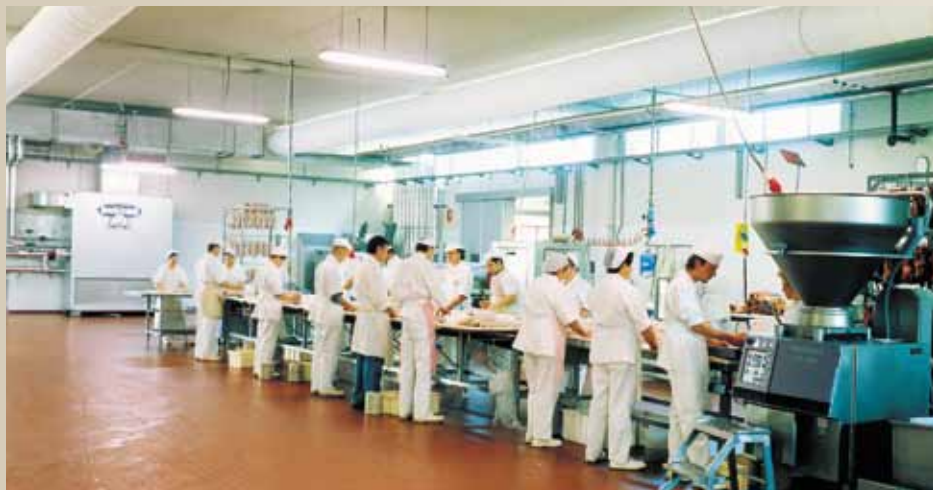
Sotto, locale di lavorazione condizionato da Frigomeccanica
